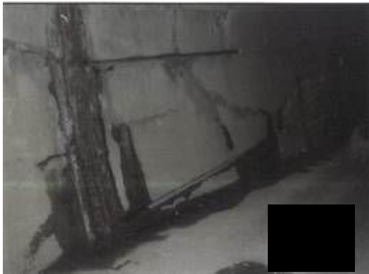
写真4-20 側壁のひびわれ、漏水
