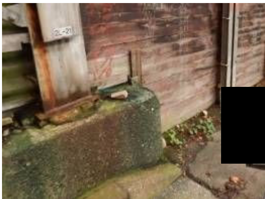
写真4-23 支承部の機能障害
