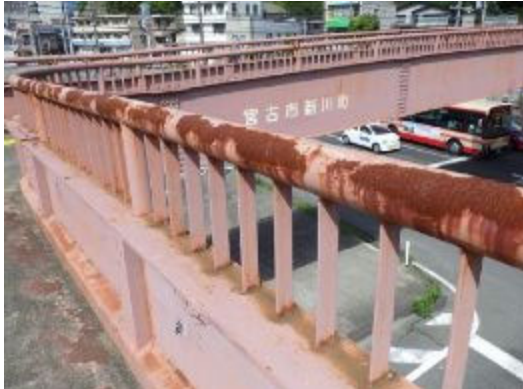
写真4-26 鋼部材の腐食
