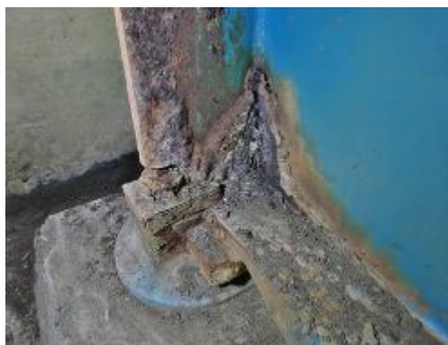
写真4-28 主桁端部の腐食
