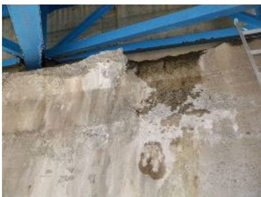
写真4-14 橋台縦壁の鉄筋露出、剥離
