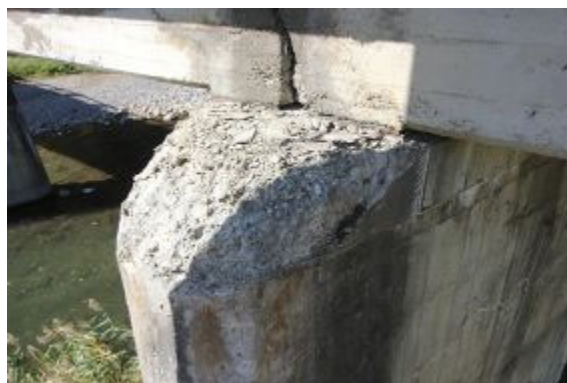
写真4-29 橋脚部コンクリートの剥離
