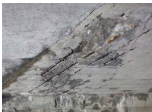
写真4-2 頂版鉄筋露出
